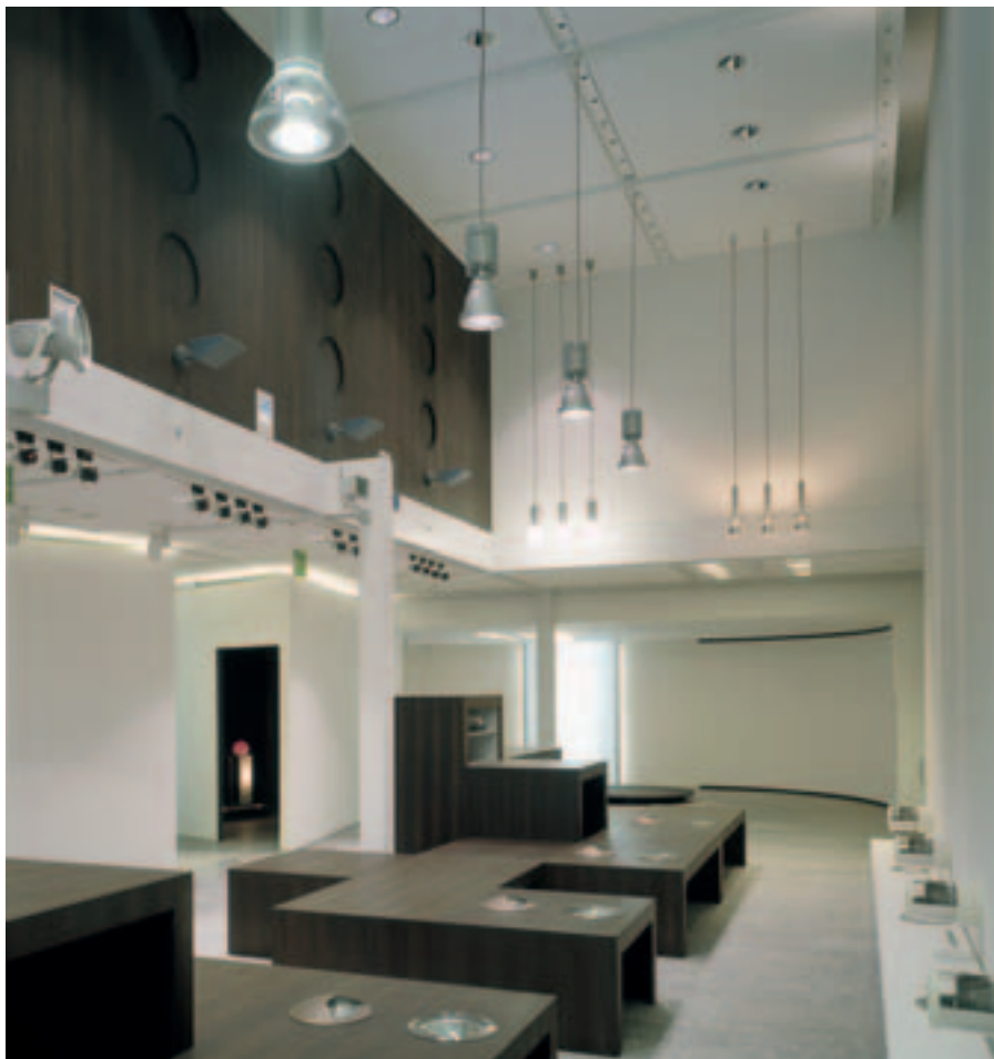
Showraum, gesamte Elektroinstallation.
