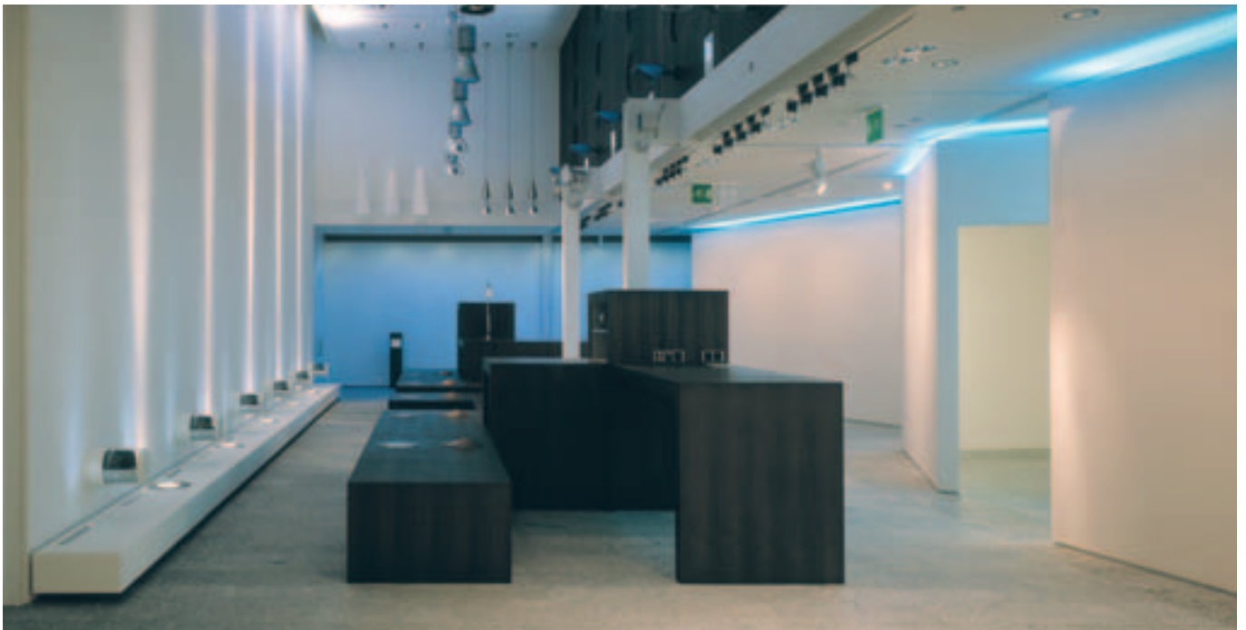
Showraum, gesamte Elektroinstallation.
