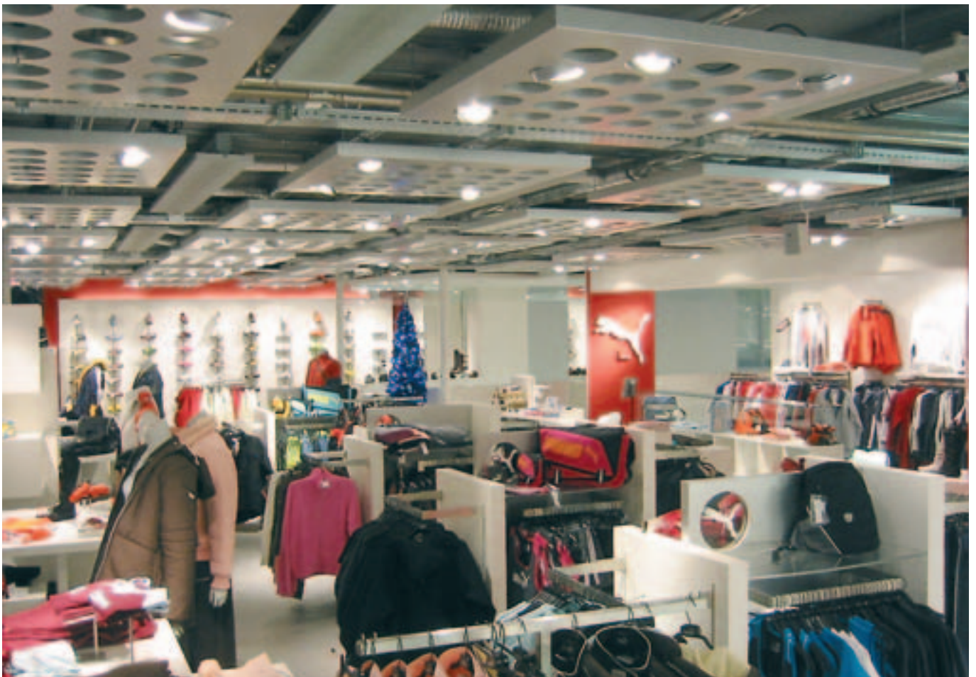
Jemoli Zürich Sportabteilung 4. OG – Decken- und Beleuchtungsmodule mit integrierten Kühlpaneelen über ganze Ladenfläche 3000 m 2 .
